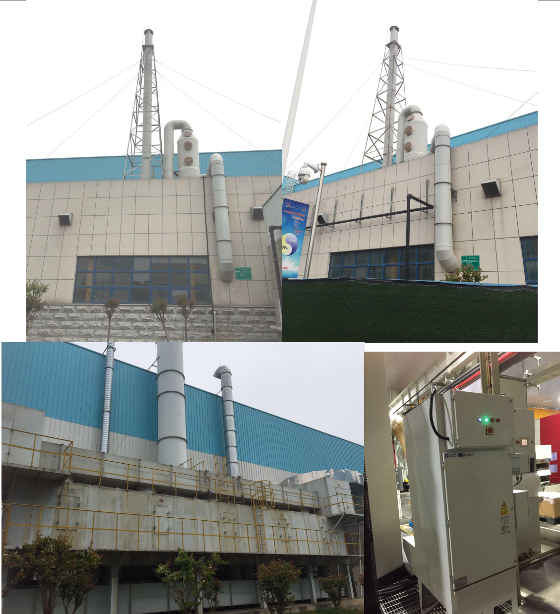
图4.1-3 废气污染防治措施图
